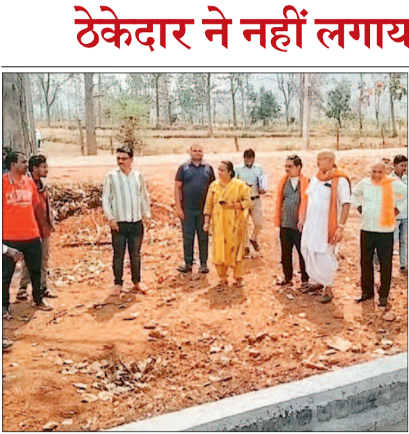
ग्रामीणों ने सीईओ को मौके पर ले जाकर दिखाया कि भवन का तल सड़क से काफी नीचे गया है जिससे बरसात के दिनों में जलभराव की स्थिति पैदा हो सकती है। पानी भरने से बच्चों को परेशानी होगी। इसके अलावा छड़ की मोटाई में भी बदलाव करने और सरकारी बोर को बिल्डिंग के भीतर लेने जैसे गंभीर आरोप लगाए गए हैं।
